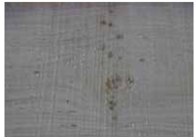
Vattskott i virket.
